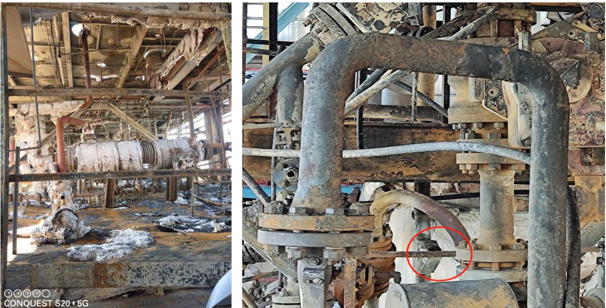
图 6、7 装置区部分设备设施损毁
