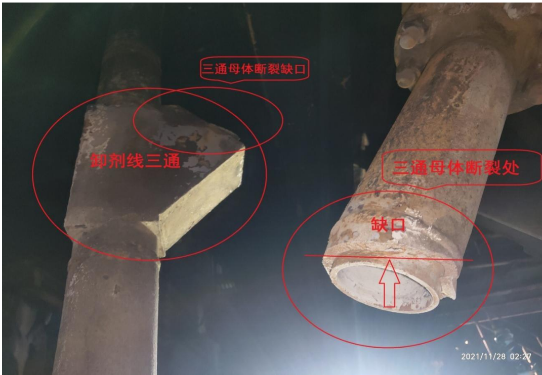
图4 卸剂线三通断裂缺口
